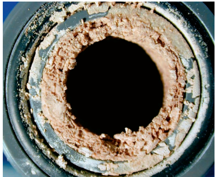
Stein des Anstosses: Der berühmte Urinstein verstopft die Leitungen (Foto Kai Udert)
